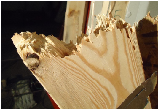
b) Brash failure of stud 4
