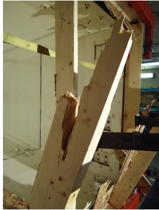
b) Brash failure of Stud 5
