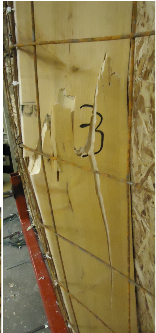
c) Failed Stud 3
