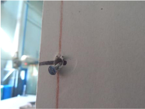
a) Ruptured Nail at Bottom Edge (Wall-4-1)
