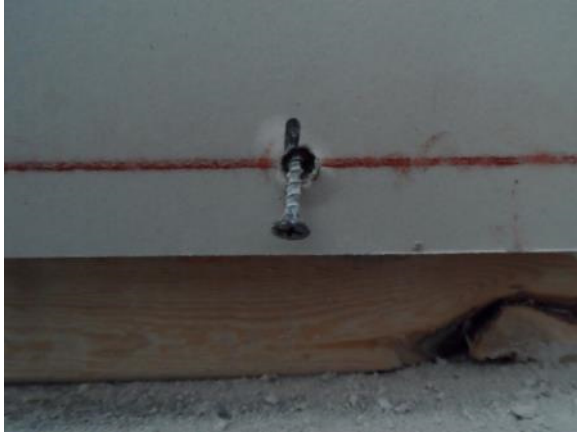
a) Ruptured Screw at Bottom Edge (Wall-3-1)
