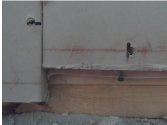
b) Edge Pull-Through at Bottom Edge (Wall-4-1)
