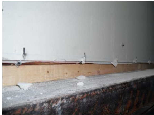
b) Edge Pull-Through at Bottom Edge (Wall-7-1)
