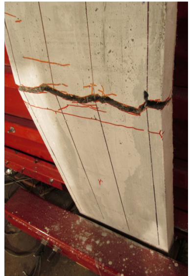
g) Tensile crack at Blast 4
