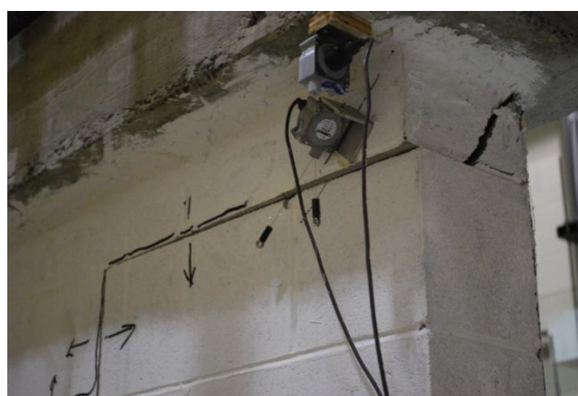
(d) Separation of a block at 1.25% drift
