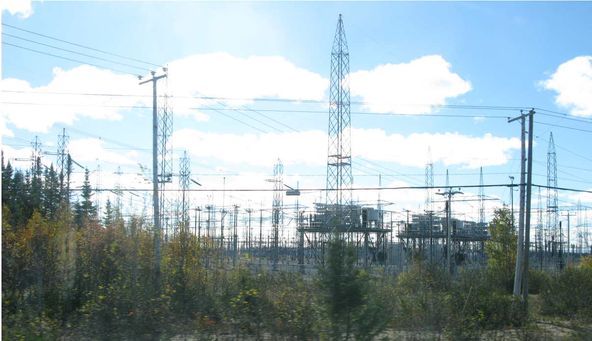
poste électrique à haute-tension le long de la route 138, dans la partie Est de Sept-Îles, 2012
